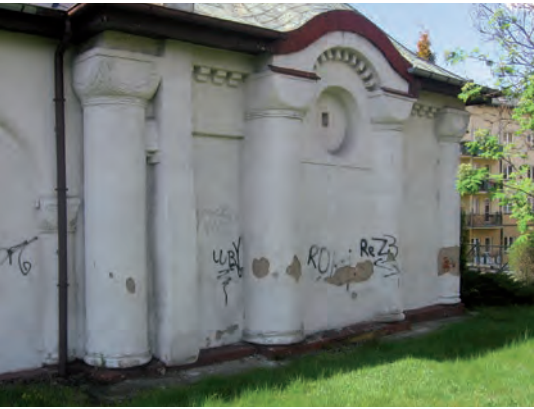
Bild 9: Ev. Kapelle in Neustettin außen in einem renovierungsbedürftigen Zustand, 2015
